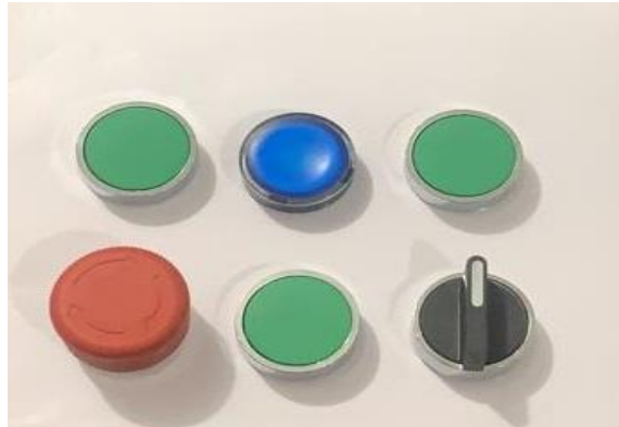
Figura 37. Botonera para control manual. (Fuente propia).
