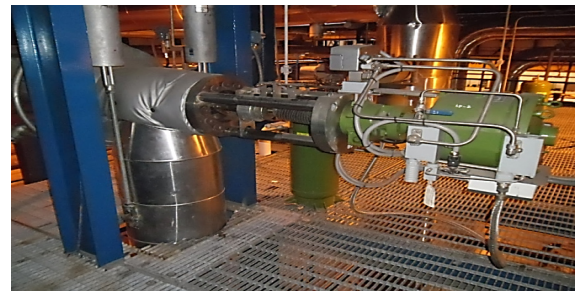
Figura 1. Válvula sistema bypass alta presión
