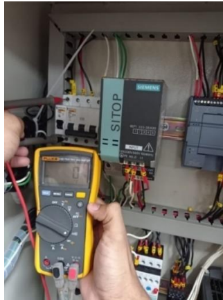
Figura 4. Prueba interruptora térmico
