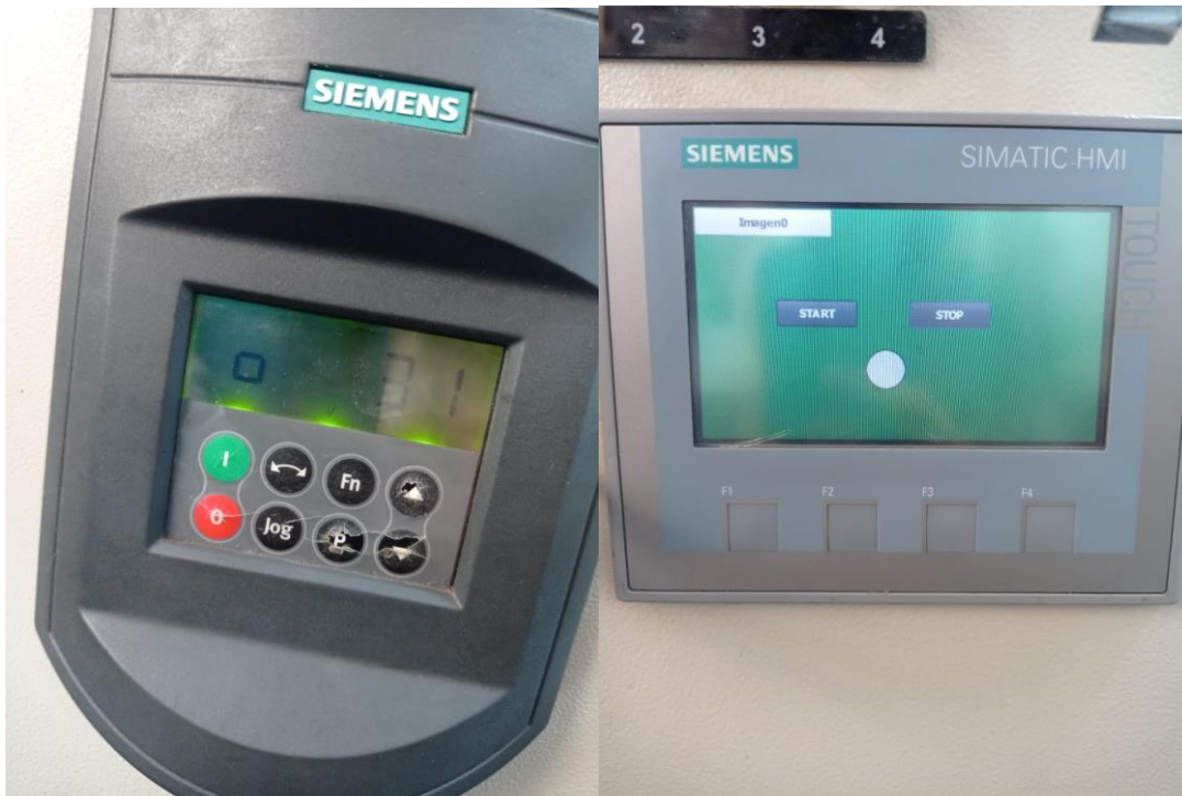
Figura 13. Prueba arranque motor
