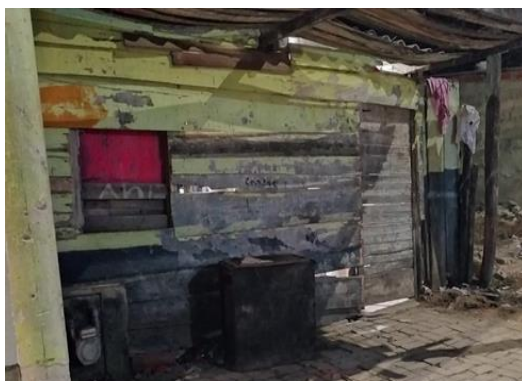
Ilustración 9: Estado actual de las casas de la zona norte del barrio la Cangrejera
