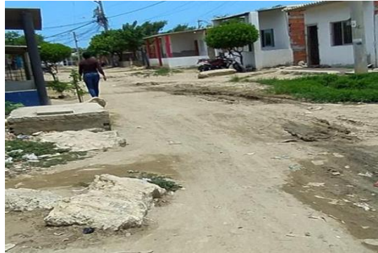
Ilustración 4: Estado actual de las calles del barrio La Cangrejera
