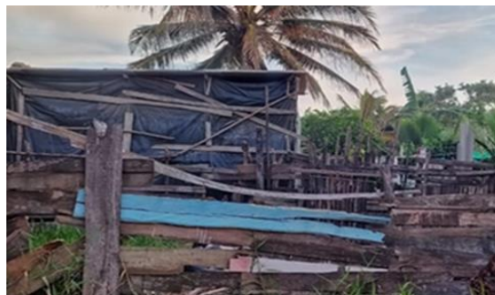
Ilustración 11: Estado actual de las casas de la zona norte del barrio la Cangrejera
