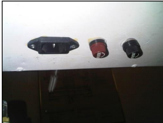
Imagen 21. Falta del cable de poder del tablero electroneumático
