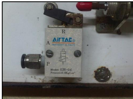
Imagen 13. Banco oxidado parte inferior
