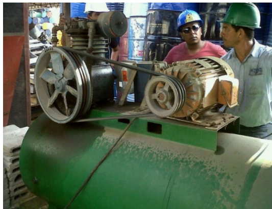
a. Compresor 1 estado actual.
