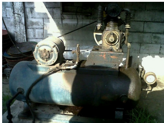
b. Compresor 2 estado actual.
