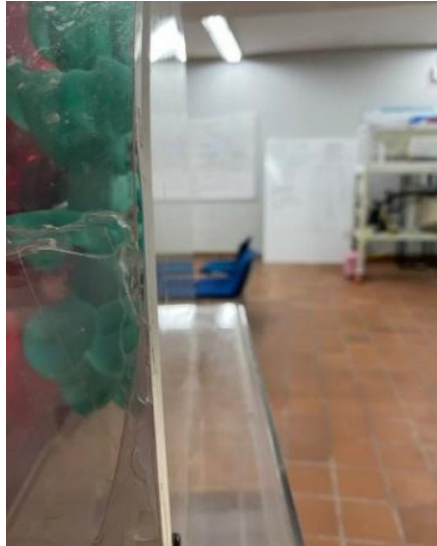
Figura 6: Fallas en fuga de la carcasa de la turbina Pelton del laboratorio Mecánica de Fluidos, propia autoría.
