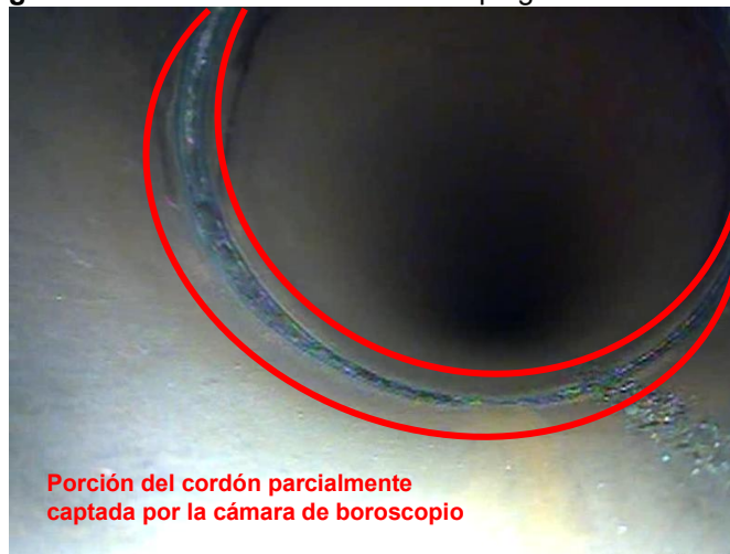
Figura 1-1 Soldadura de tubería de 6 pulgadas no centrada.
